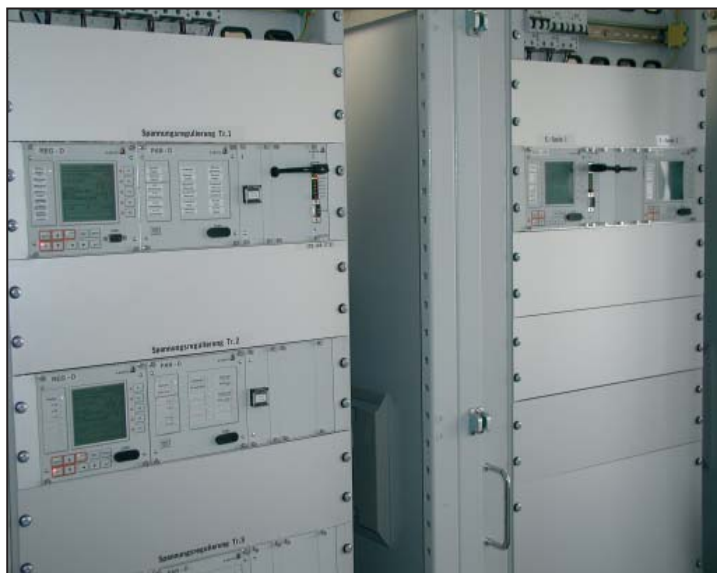
Drei Spannungsregelsysteme REGSys™ bestehend jeweils aus einem 19"-Baugruppenträger bestückt mit Spannungsregler REG-D, Überwachungseinheit PAN-D, Stufenstellungs-Interface REG-FR und Leittechnikanschlussbaugruppe REG-PE, sowie zwei Petersen-Spulenregler REG-DP, leittechnisch angebunden gemäss IEC 61850
