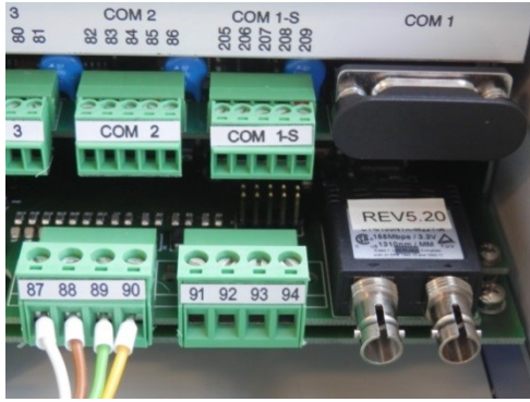
Оптоволоконный разъем (1 x Ethernet-ST, XW93) на уровне II; порты Com регулятора REG-DA на уровне III
