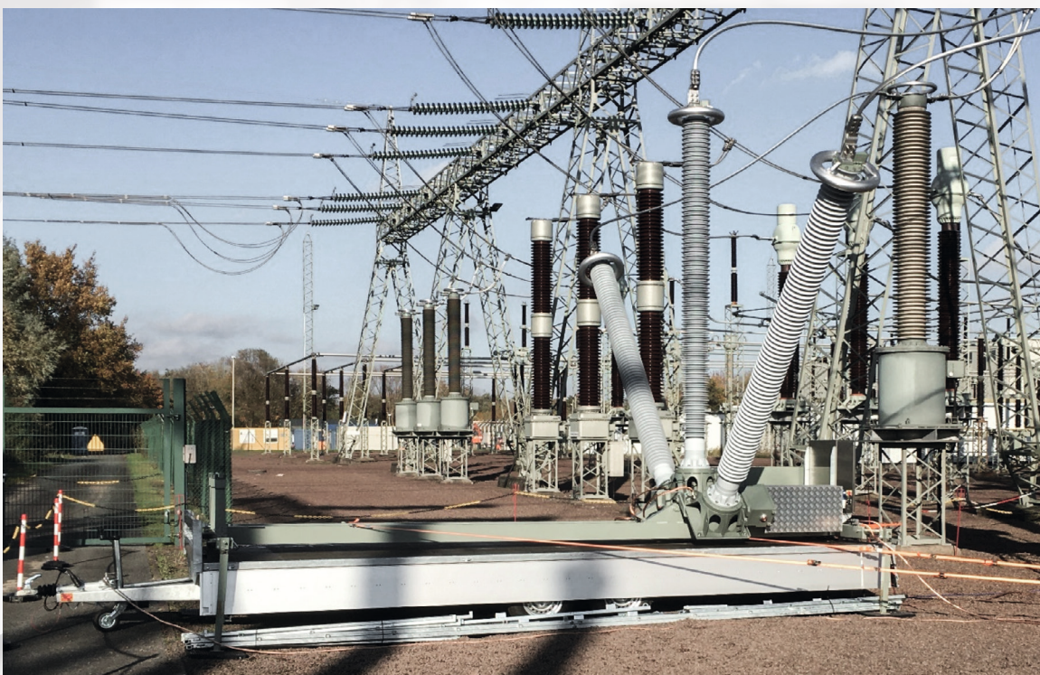
Abbildung 5: Mobiler RC-Teiler zur temporären Messung der Power Quality im Umspannwerk Unterweser
