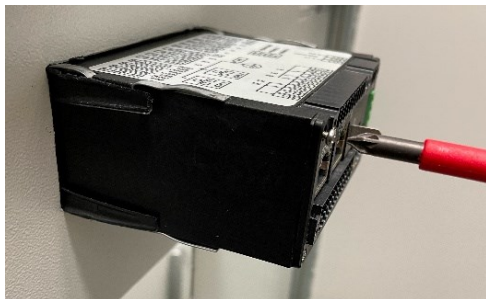
EOR-3DS noch ohne Adapter montiert in Schalttafel
